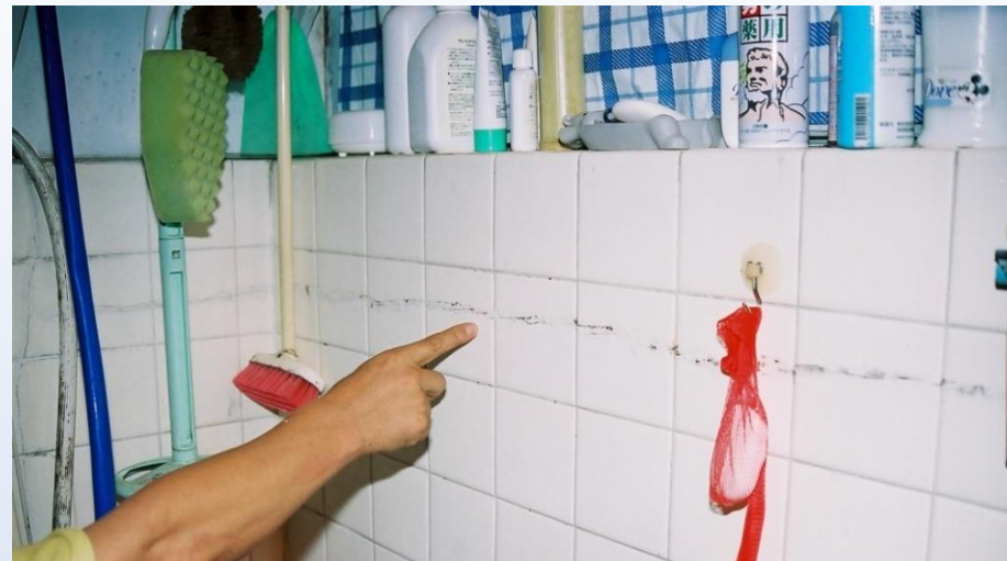
タイルのクラック (ひび割れ)
