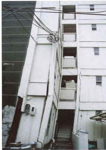
彎曲した鉄骨柱
