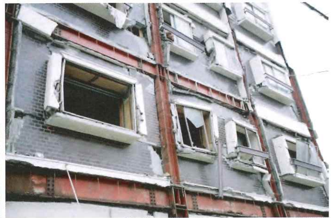
鉄骨柱・梁の被覆とサッシガラスの脱落
