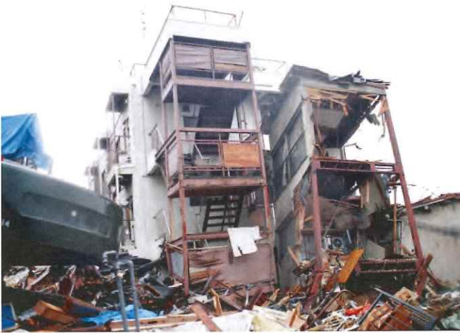
外壁が脱落し無くなった鉄骨建物
