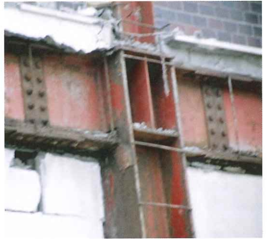
被覆が脱落した鉄骨柱・梁の接合部の詳細
