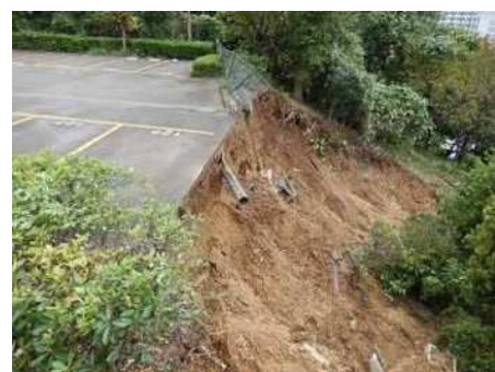
写真 3 崩壊 のり 法面上部の状況
