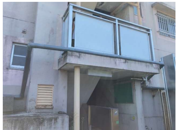
* 外壁に敷設された給水管
