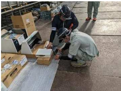
図 15 電動給気シャッターの仕様確認
