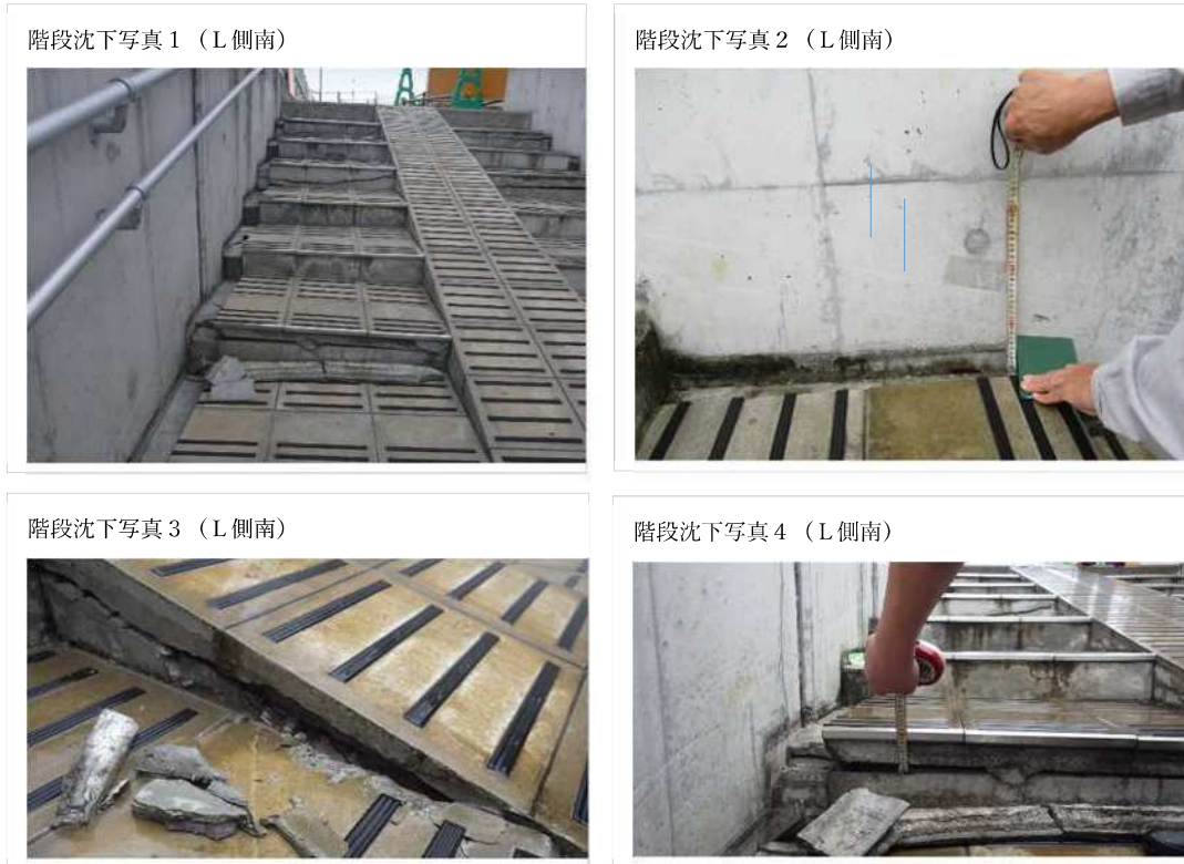
写真3 階段部の沈下・クラック発生状況写真
