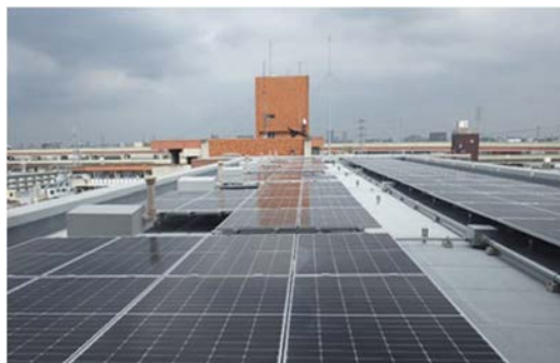
図表 2-3-7 既存都営住宅への太陽光発電設備の設置例
