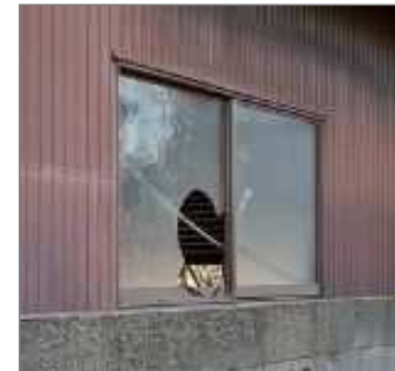
窓が割れた管理不全空家
