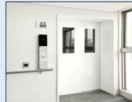
タッチレス型エレベーター（提供：東京都住宅供給公社）
