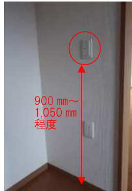
写真Ⅱ.9 子どもの手の届きやすい高さ（床上 1,050 mm以下）に設置された電気スイッチ
