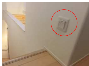
写真Ⅱ.20 階段の段差位置を確認できる場所に 設置された足元灯
