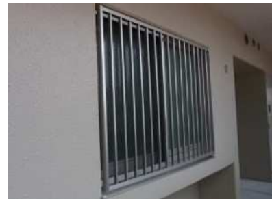
写真Ⅱ.6 共用廊下に面する窓に取り付けられた 面格子
