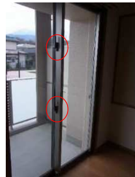
写真Ⅱ.5 2 か所（1 か所は小さな子どもの手の届かない 高さ）に取り付けられたクレセント錠
