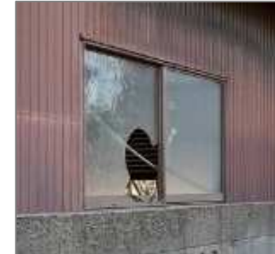
窓が割れた管理不全空家
