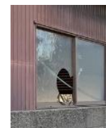
窓が割れた 管理不全空家
