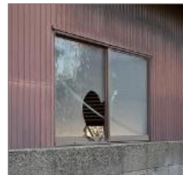
窓が割れた管理不全空家
