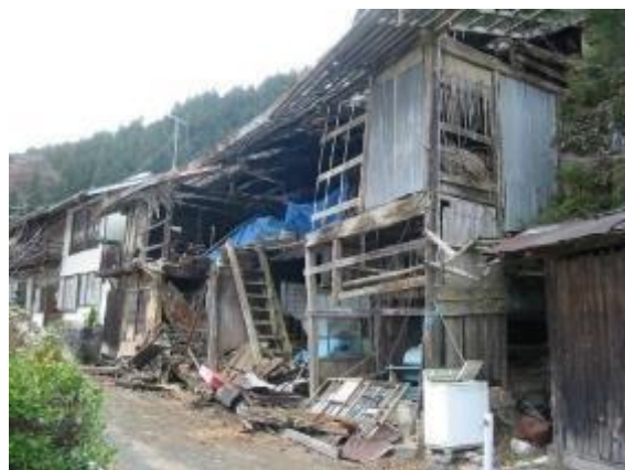
倒壊のおそれのある空き家
