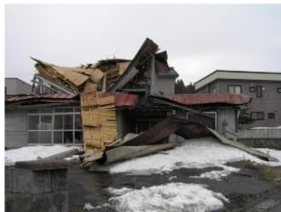
積雪により屋根が落下した空き家
