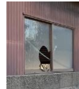
窓が割れた管理不全空家
