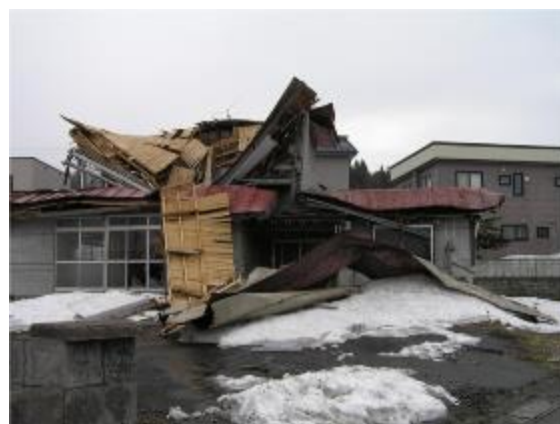
積雪により屋根が落下した空き家
