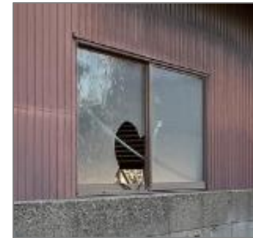
窓が割れた管理不全空家
