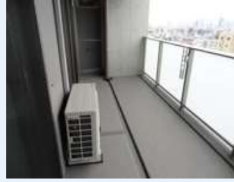
室外機が足がかりとならないように 手すりとの間に距離を確保
