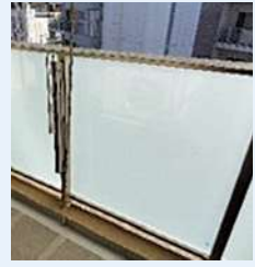
転落防止のための 手すり
