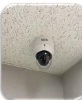
防犯カメラを新たに設置
