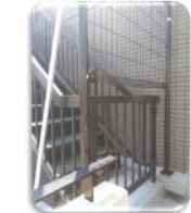
危険な箇所は施錠し、 立ち入れない措置を実施
