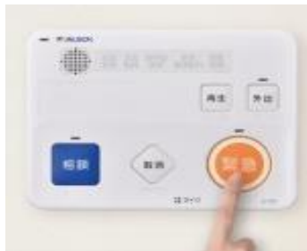
・見守り設備
