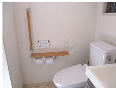
手すりの設置されたトイレ
