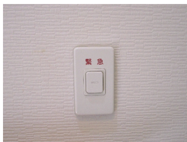
住戸内に設置されている通報ボタン
