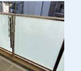
転落防止のための 手すり
