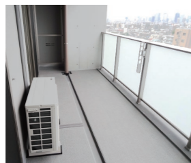
足掛かりのないバルコニー手すり
