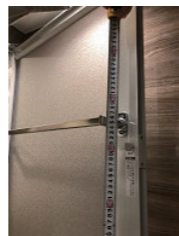
子供が進入できない高い位置に浴室錠設置
