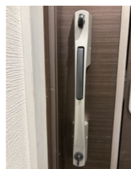
ダブルロックによる玄関扉の侵入防止対策
