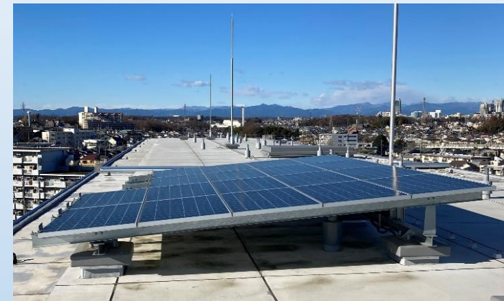
太陽光発電設備の設置例
