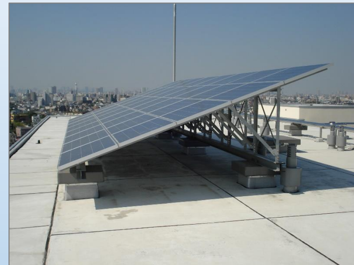
太陽光発電設備の設置例
