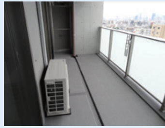
室外機が足がかりとならないように 手すりとの間に距離を確保
