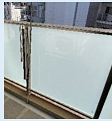
転落防止のための 手すり
