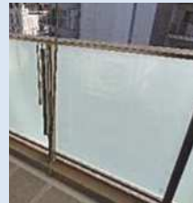
転落防止のための 手すり
