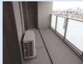
室外機が足がかりにならないように 手すりとの間に距離を確保
